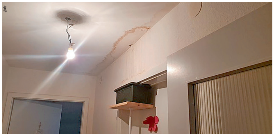
Des infiltrations d'eau dans le logement n'ont pas suffi à faire bouger la gérance. Les locataires ont fini par opter pour la consignation du loyer.
