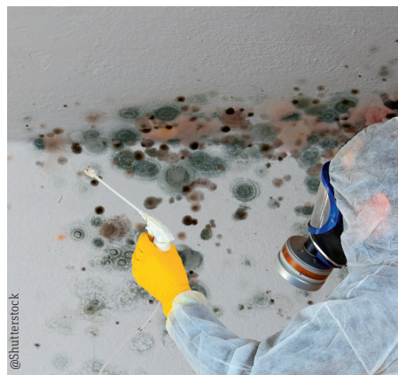
A Neuchâtel, les problèmes de moisissures représentent près de 60% des activités du service de salubrité.
